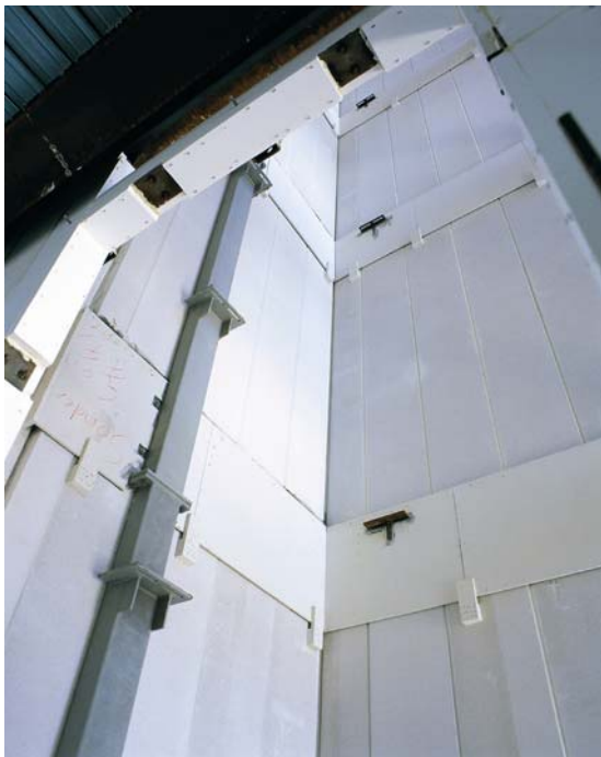
Abb. 3: Commerzbank-Hochhaus, Frankfurt/Main Architekt: Sir Norman Forster Massiver Brandschutz mit Porenbeton: Ausführung der Wände an den Treppenhäusern und Fahrstuhlschächten aus bewehrten Porenbeton-Wandplatten.
